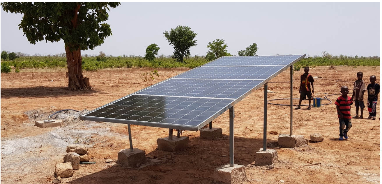
© Ulrike Däßler: die Solaranlage für den Brunnen
